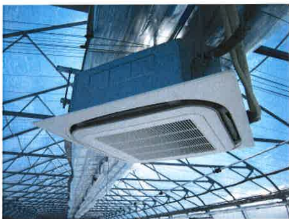
ハウス栽培に導入したヒートポンプシステムの室内機(ダイキン)
